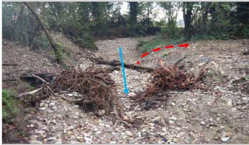
Rio Lavezza—Segmento 3e— Al termine dei lavori di posizionamento di SALTO DI FONDO CON RADICI ESPOSTE (16/10/2014). In ROSSO: andamento delle portate di piena verso la piana inondabile, riconnessa grazie all'innalzamento locale del fondo conseguente alla sistemazione in alveo dei tronchi
